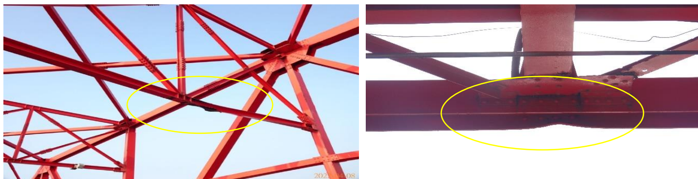
4-10 西螺大橋鋼構件彎曲
