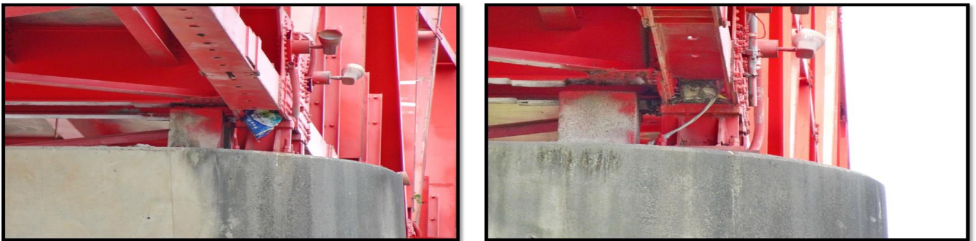
4-2 西螺大橋下弦雜物阻塞
