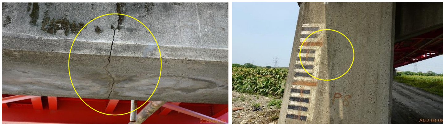
4-8 西螺大橋橋墩裂縫
