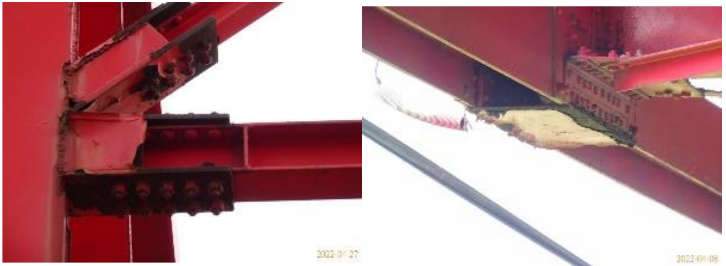
4-11西螺大橋鋼構件脫漆鏽蝕
